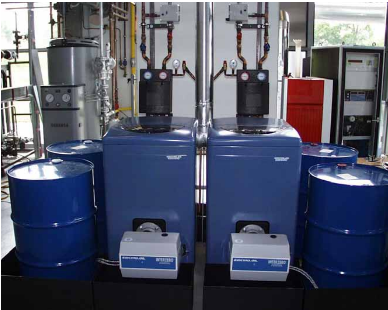
Prüfstand mit zwei baugleichen Niedertemperaturkesseln der Fa. Electro Oil
