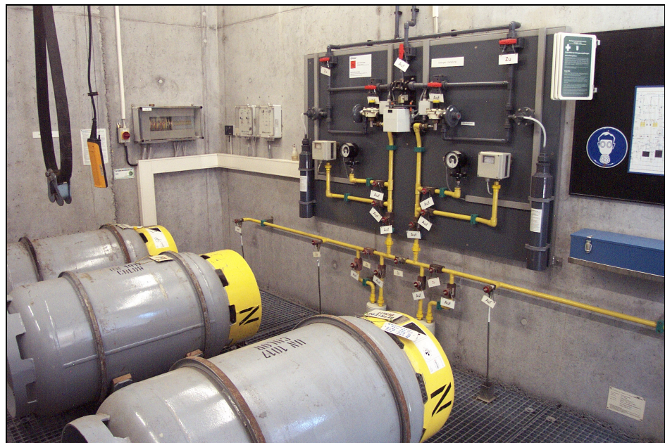
Beispiel für einen Chlorgaslagerraum (Fässer 500 kg)
