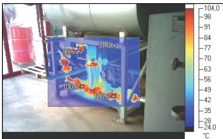
Abb. 2: Aufnahme der Speisewasserpumpen mit einer Wärmebildkamera
