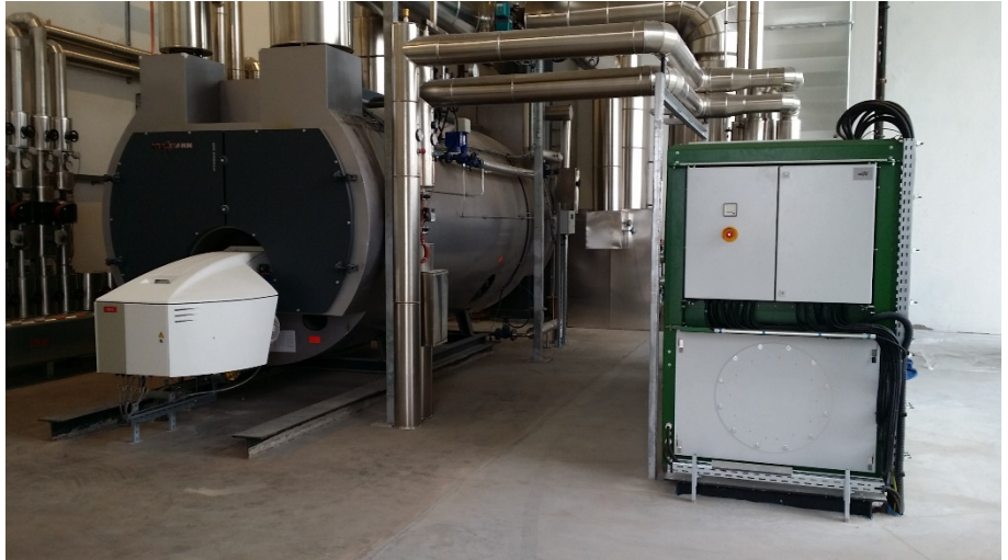
Abb. 1: Neu errichtetes BHKW und Sattdampfkessel der Fa. Biederlack in Greven.
