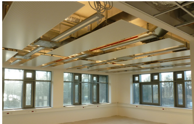
Abb. 2: ausgeführte Leistungen der Installationen im Konferenzraum
