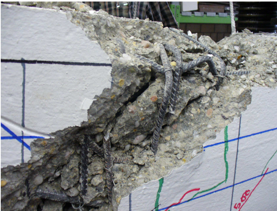
Totales Versagen des Bauteils im Bereich der Ausklinkung
