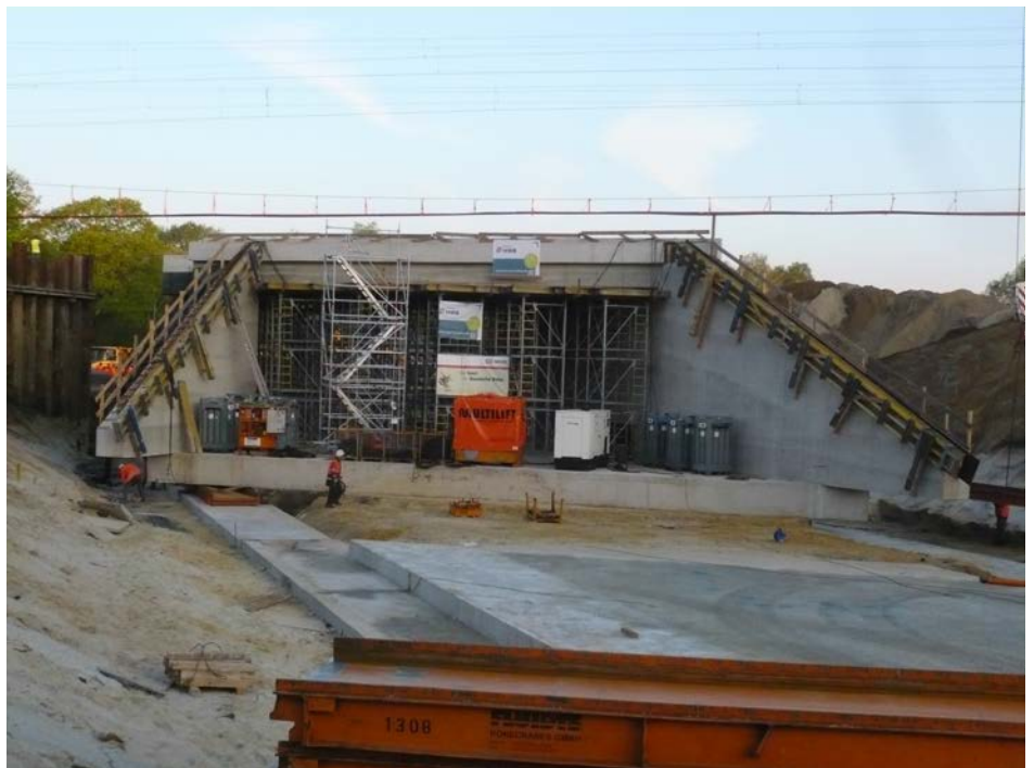
Das verschobene Brückenbauwerk
