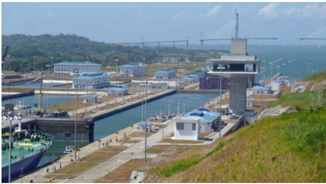
Agua-Clara-Schleuse: Das Rolltor zwischen der oberen und mittleren Kammer (linke Bildseite) befindet sich gerade im Öffnungsvorgang, Kontrollturm, im Hintergrund die im Bau befindliche 1050 m lange Schrägseilbrücke „Atlantic Bridge“
