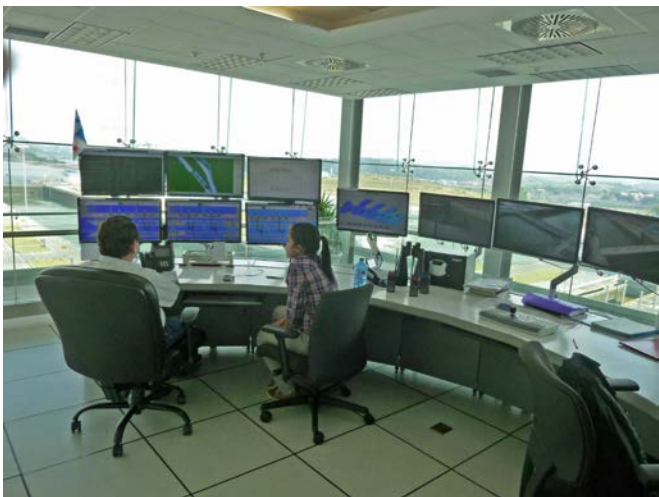
Leitstand auf dem Kontrollturm mit Überwachungsmonitoren für die Schleusentore, Wasserkanäle und Außenkameras
