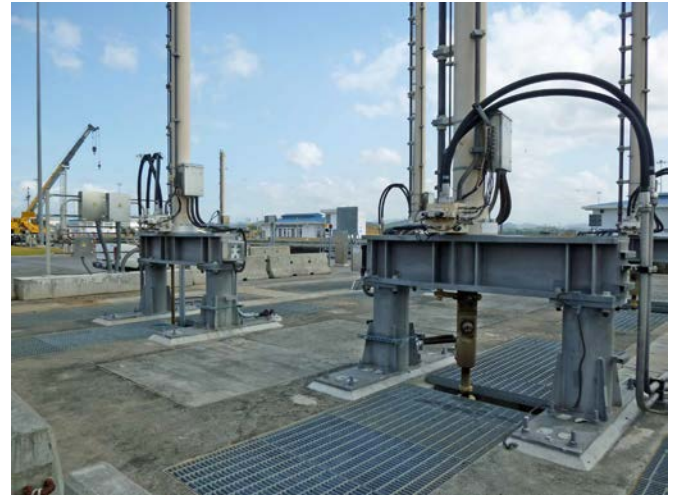
Hydraulische Antriebe der Schütze in den unterirdischen Wasserkanälen
